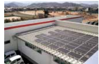
太陽光パネル(東部支所)
